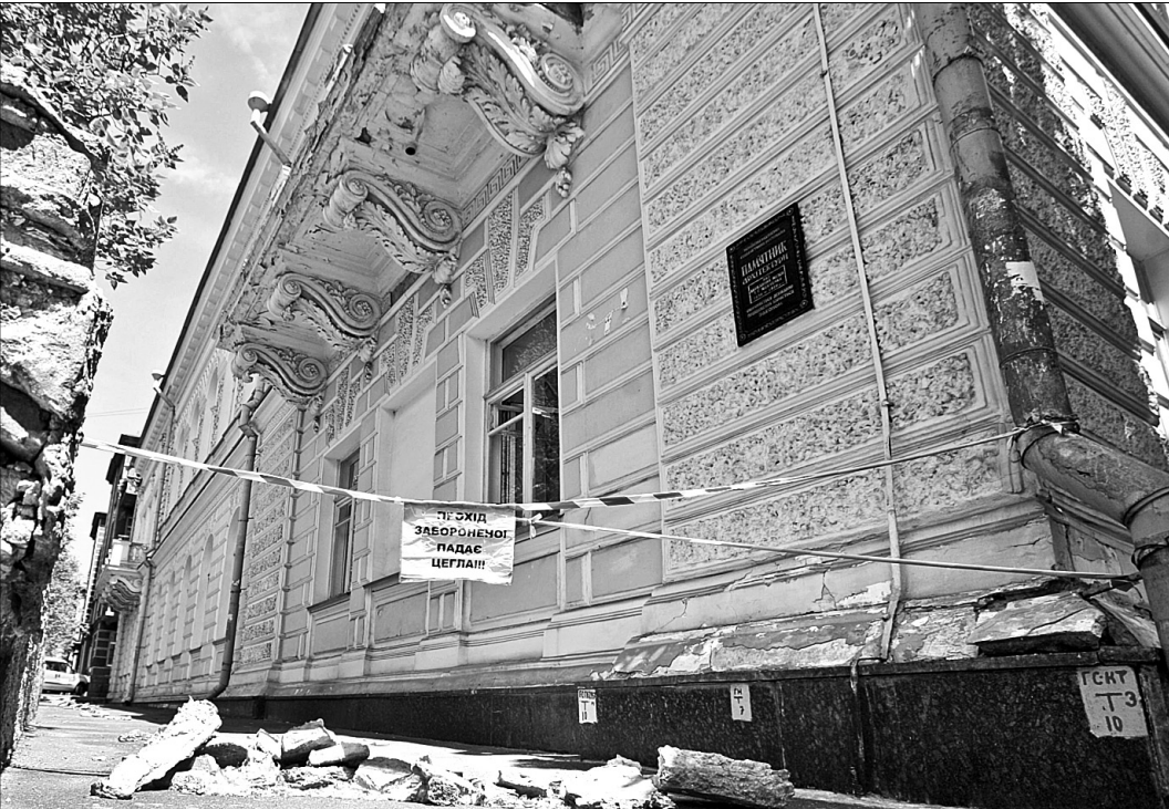
Через неякісні роботи з гідроізоляції під час попередніх ремонтів будівля Національного музею Тараса Шевченка перебуває у жалюзяному стані
