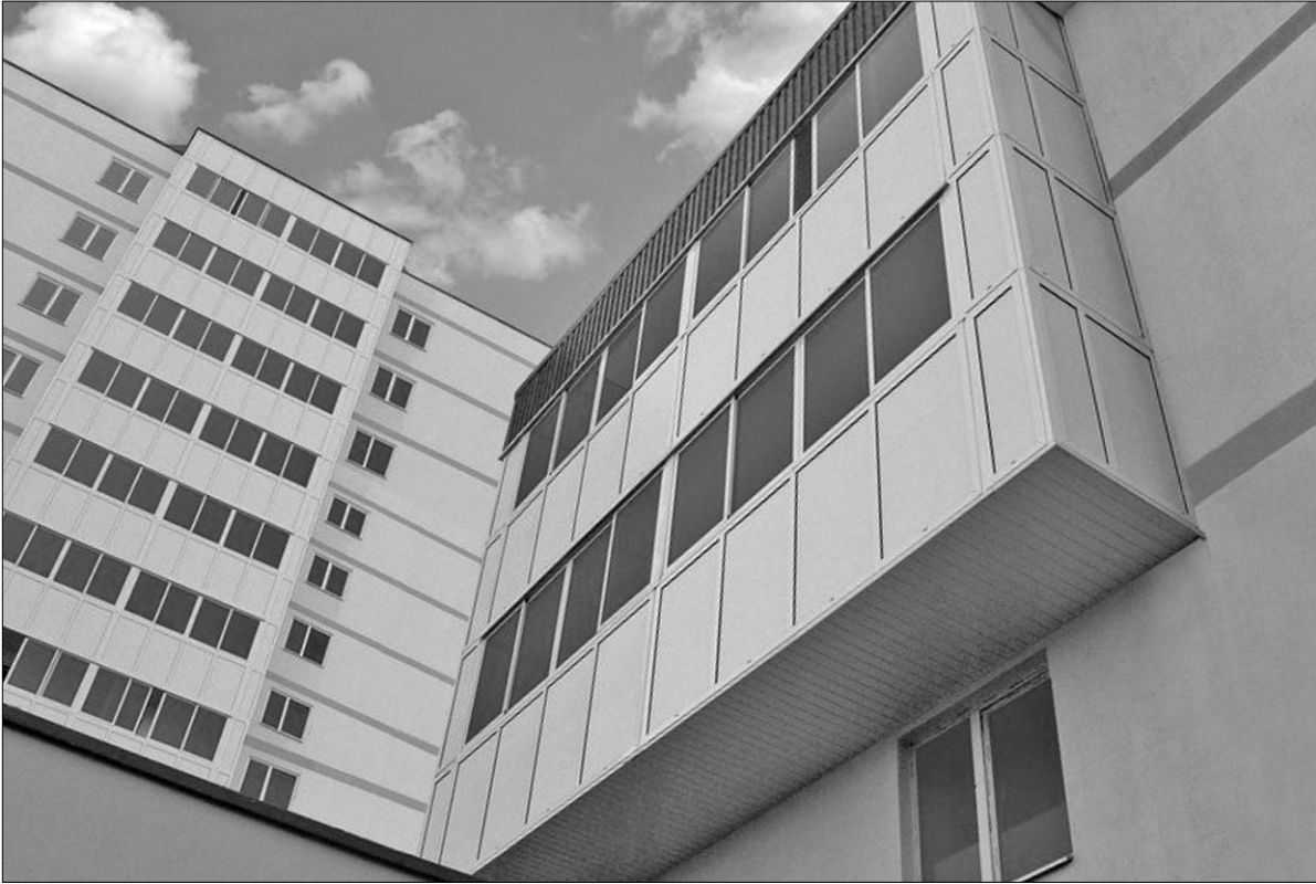
Найбільш проблемним на сьогодні є питання — втручання в несучі конструкції будівель, що може призвести до негативних наслідків
