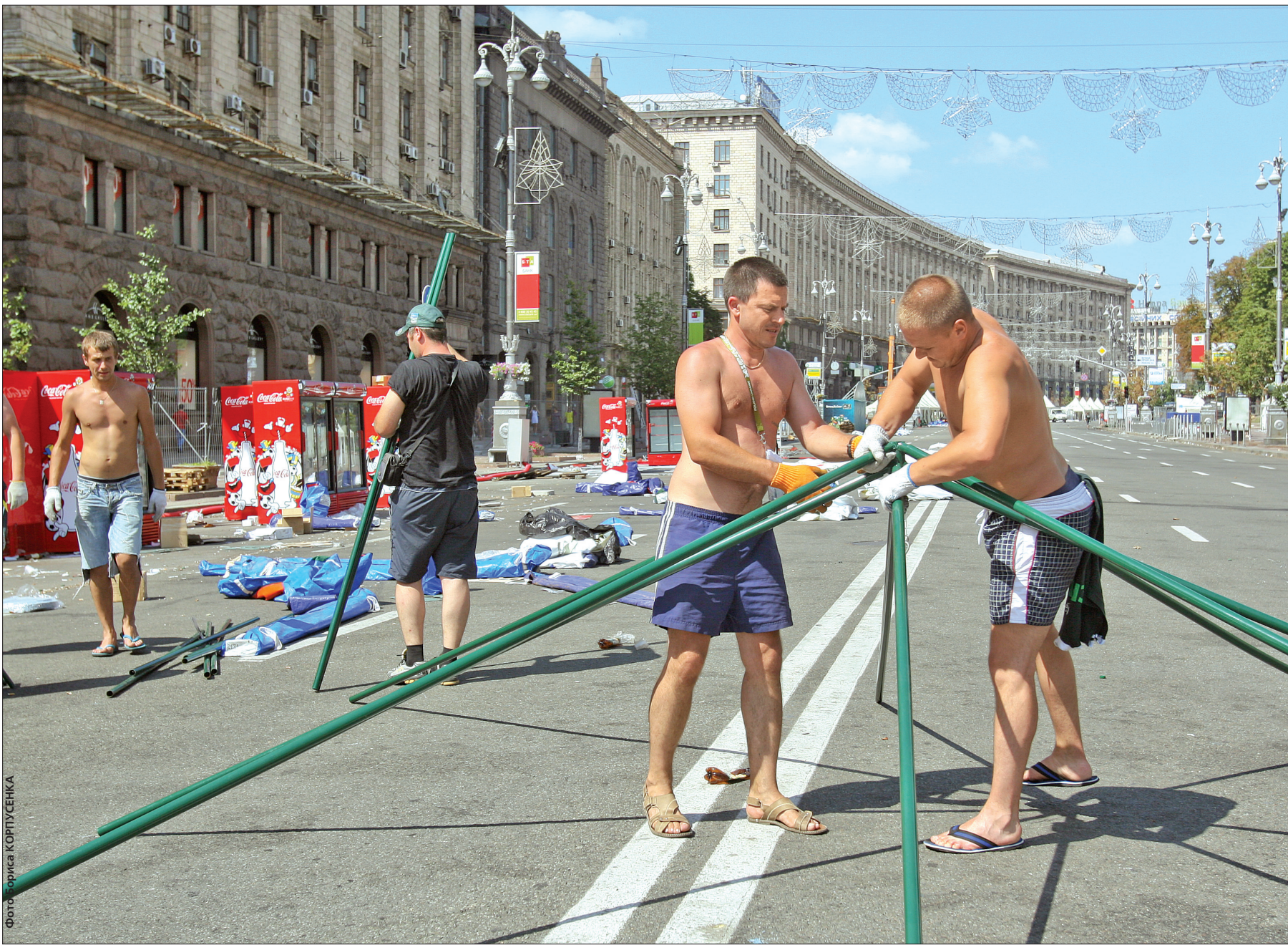
Демонтаж конструкцій столичної фан-зони триває. До кінця тижня на Хрещатику обіцяють відновити рух транспорту
