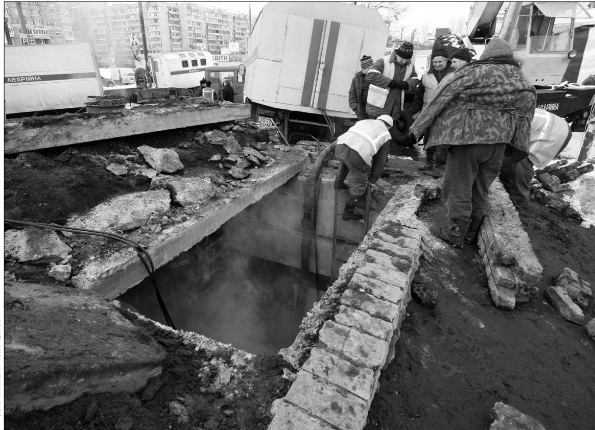
Щоб поривів на теплотрасах взимку було менше, перевірку систем теплопостачання комунальники почали завчасно
