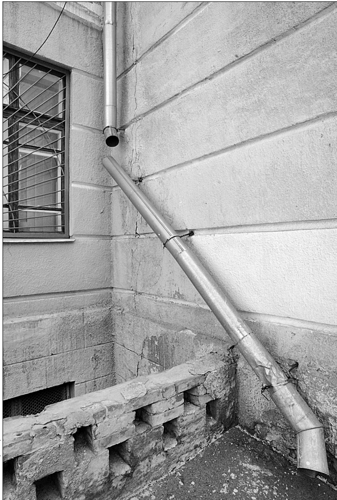
Пошкоджена труба повільно руйнує будинок на вулиці Празькій, 4
