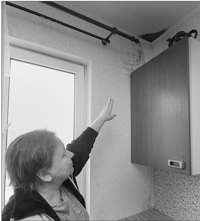
Через протікання стіни і грибок киянці Тетяні Свинцовій щороку доводиться робити ремонт у квартирі
