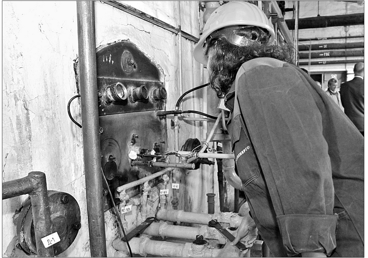
Обладнання на тепловій станції №1 на сьогодні тримається на "доброму слові", бо встановлювали його ще у 1937 році
