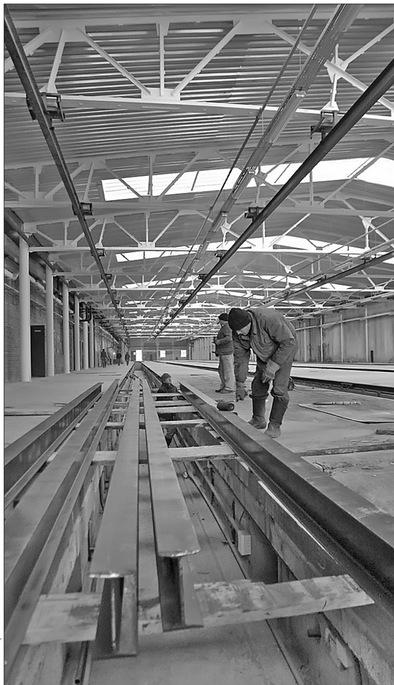
На новій станції "Червоний хутір", що за "Бориспільською" Сирецько-Печерської лінії, наводять останні оздоблювальні штрихи. Відкрити її планують за тиждень до Дня Києва
